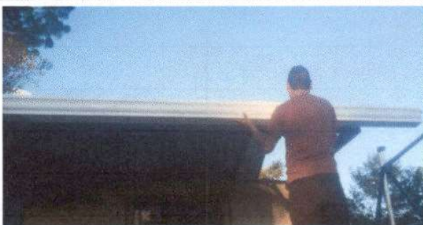
Foto 5: Canales y bajada de agua pluvial
